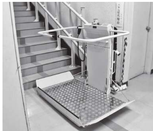
七ツ森小学校に設置された昇降機
