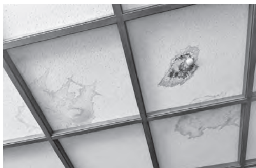
雨漏りが点在する町営体育館の天井
