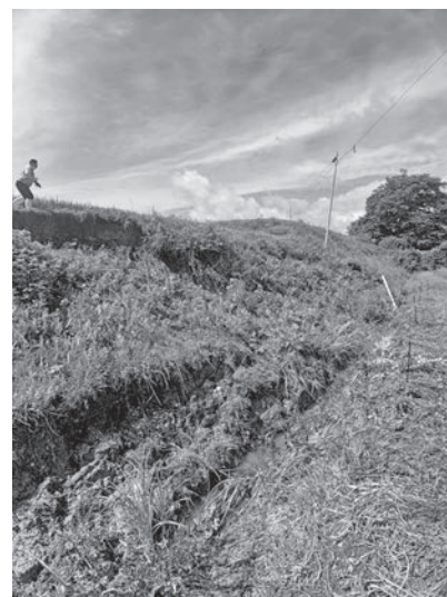
雨により崩壊した水路のり面
