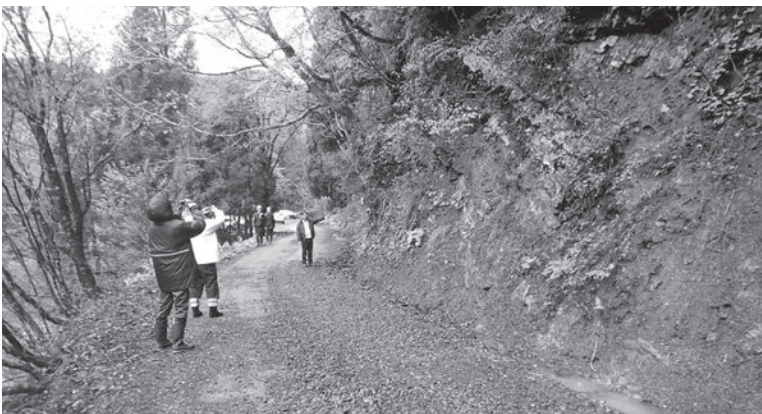
道幅も狭い落石のあった林道
