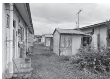
築60年。老朽化が著しい町営住宅
