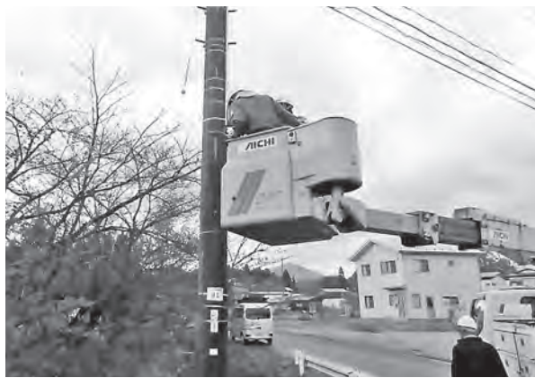
点検で安全が確認された町内の防犯街路灯
