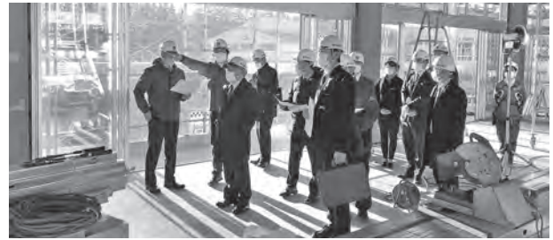
アーチェリー屋内射場の工事進捗状況を確認する委員たち
