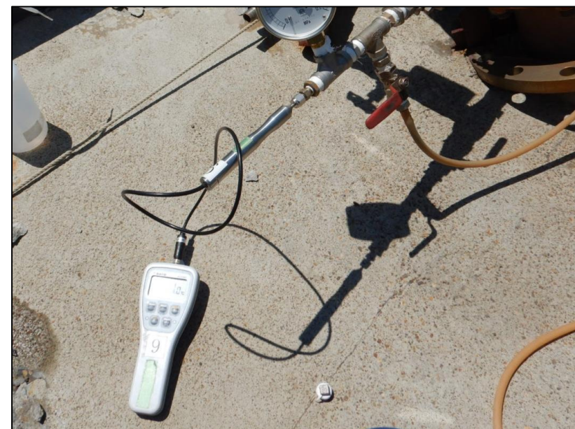
蒸気モニタリング(坑口の温度測定)
