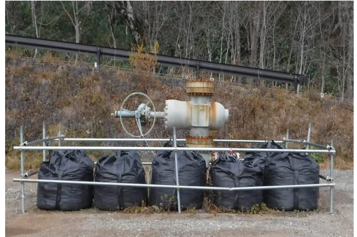
安全設備の設置状況 (2024年11月11日)
