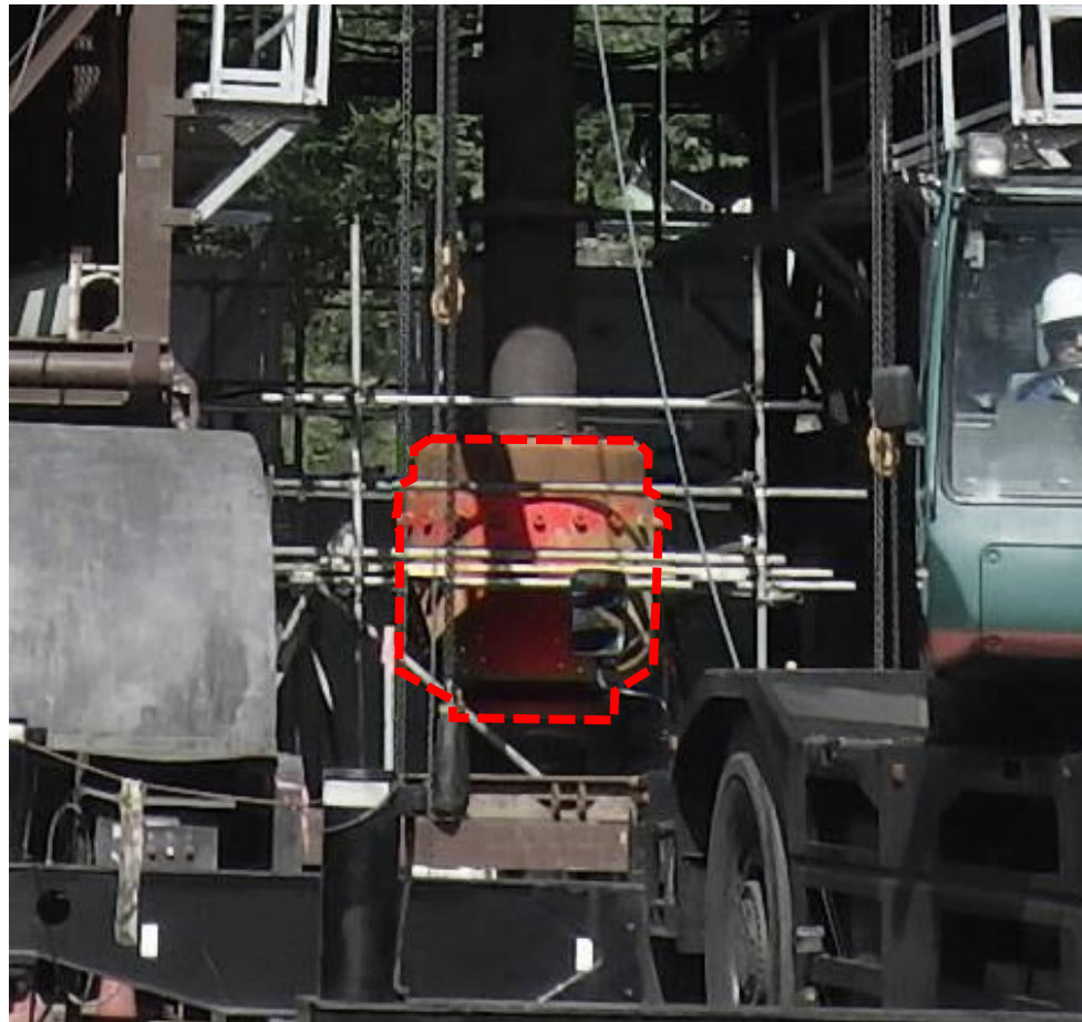
大松倉山南部地域で使用した噴出防止装置(破線部で囲まれた装置)
