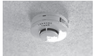
▲住宅用火災警報器の点検を
