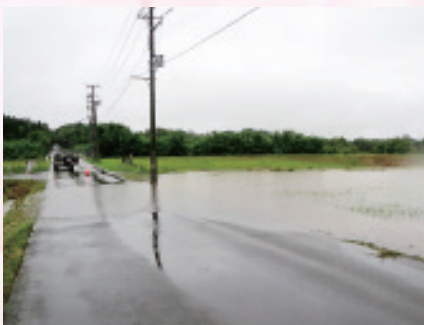
冠水し一時通行止めになった栗石大橋付近の町道 (7月23日)
