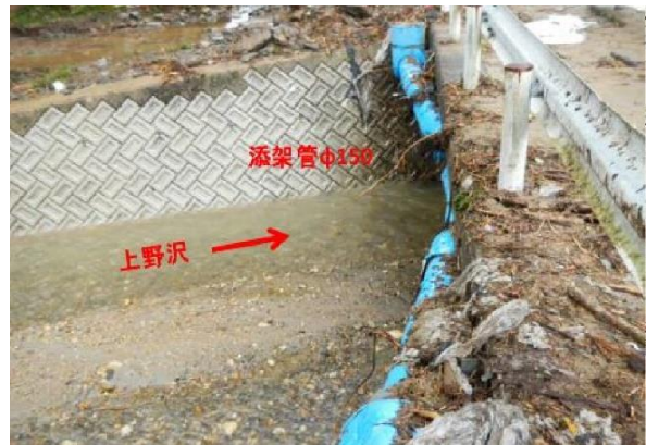
（豪雨により上野沢上流から流木が流れ、水管橋が破壊された様子）
