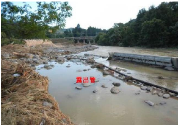
（雫石川の氾濫で土砂が押し流され、埋設していた管路が露出した様子）
