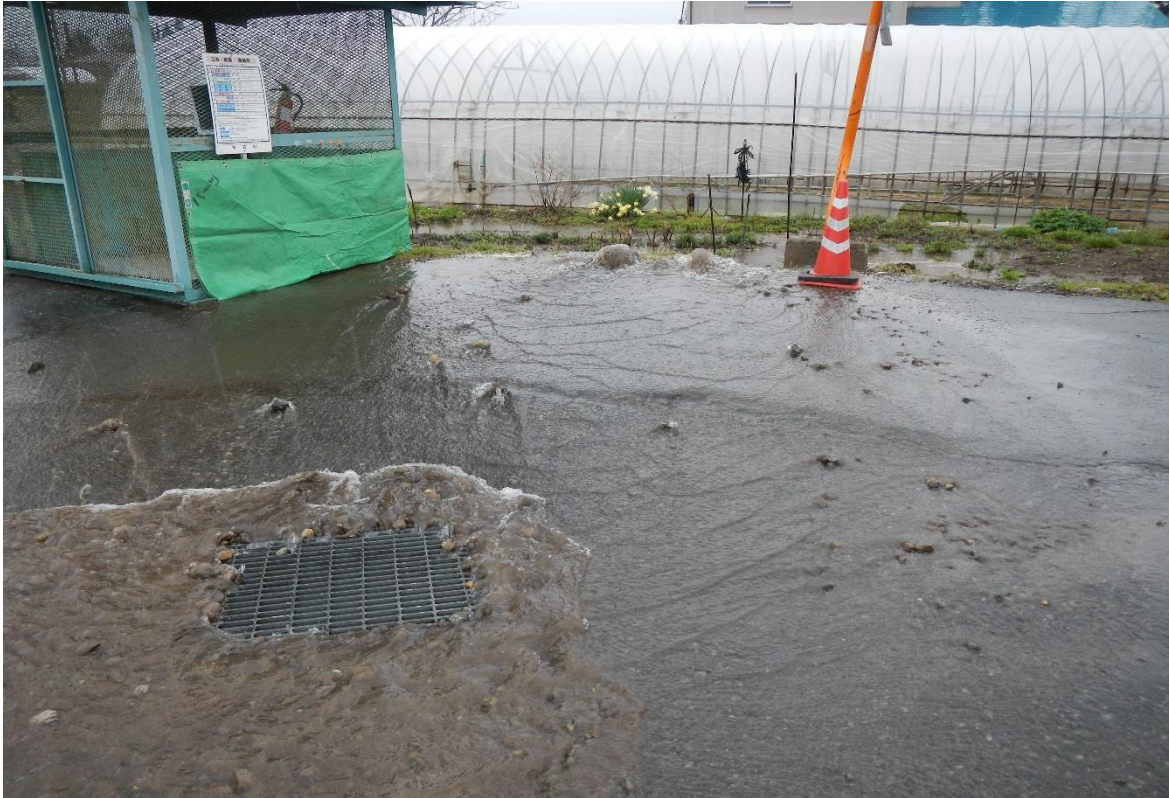
＜雫石町内で発生した漏水＞
