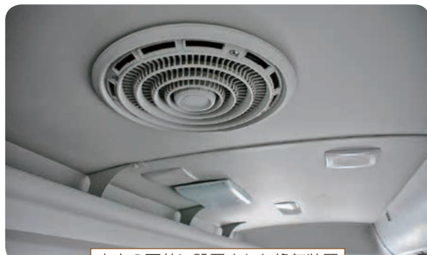
車内の天井に設置された換気装置
