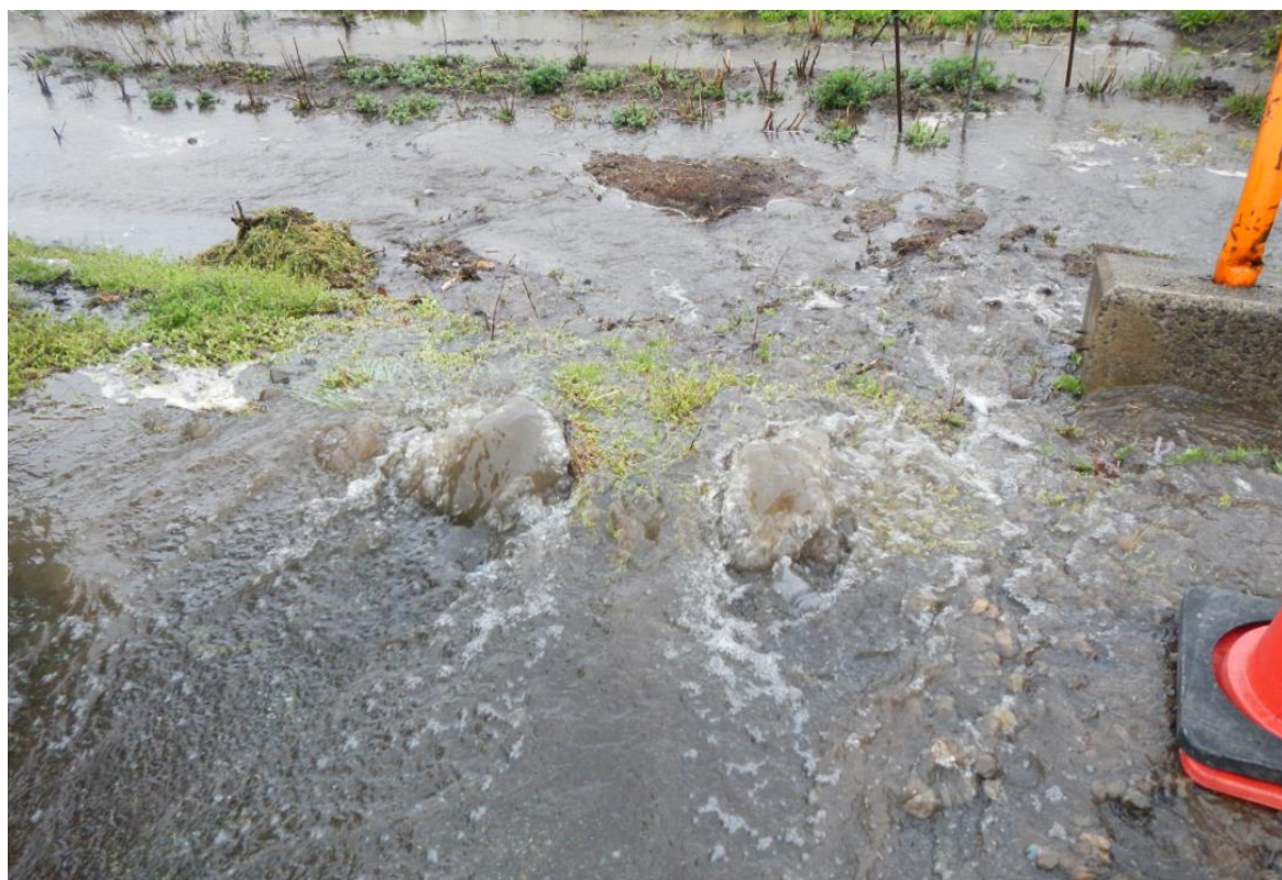
＜配水管の老朽化による漏水事故 場所：上野下川原地区 平成 28 年4月＞
