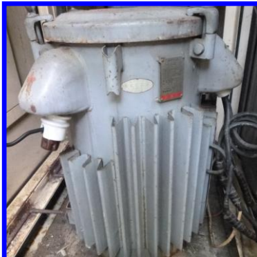
トランス（変圧器）
