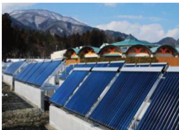
図 30 紫波町ラ・フランス温泉館の太陽熱温泉システム
