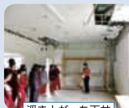
浮き上がった天井
