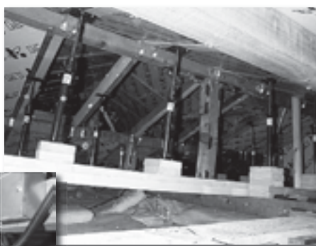
◀床下に積まれた調湿剤と無意味に取り付けられた換気扇
