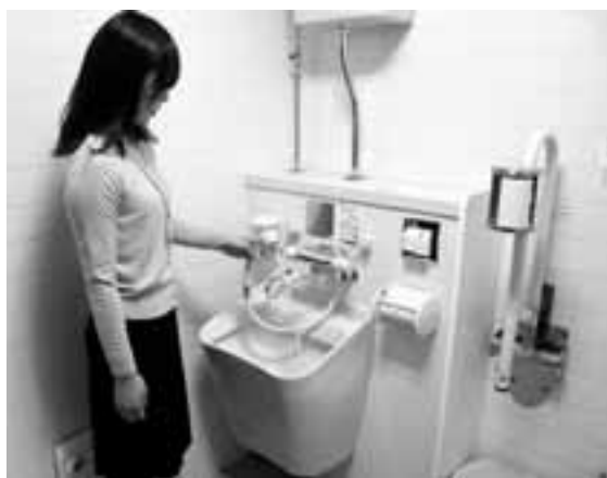
役場庁舎3階に整備されたオストメイト対応トイレ
