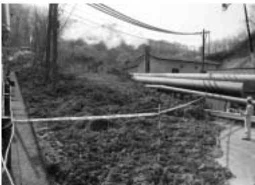
崩落による土砂で埋まった県道西山生保内線(滝ノ上地内、5月2日)
