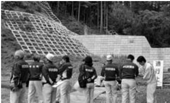
復旧現場を視察する委員
