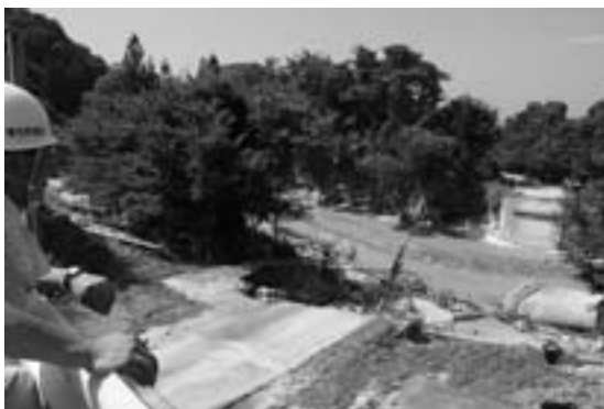
流失した矢櫃橋
