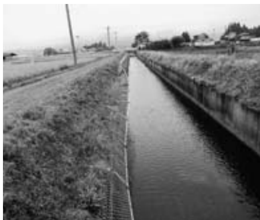
河川フェンスが倒れて危険な状態になっている
