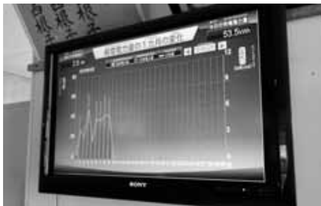
西根小学校に設置された太陽光発電設備
