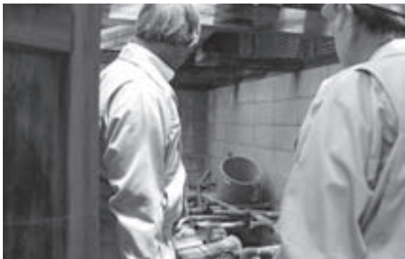
鶯宿温泉貯槽分湯施設
