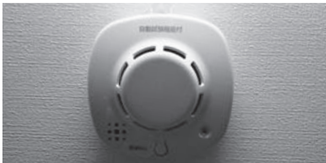
設置が急がれる火災報知機
