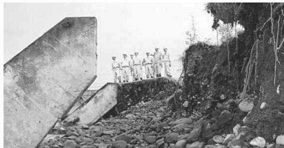
西根地区平出川護岸決壊の状況
