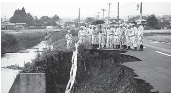
御明神四ツ家ライスセンター付近の町道環状線路盤崩壊の様子
