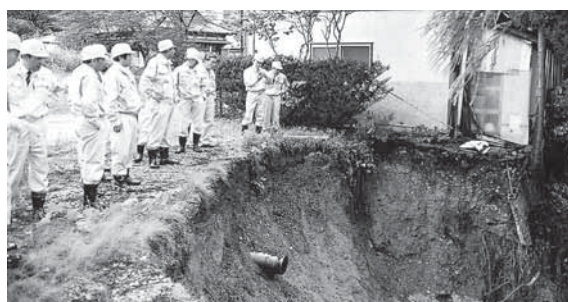
鷲宿行政区の土砂崩れ現場
