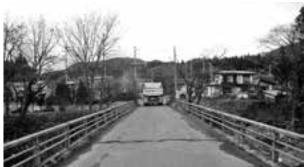
幅員が狭く老朽化が著しい昇瀬橋
