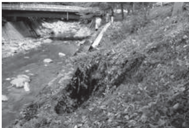
岩座橋下流の陥没
