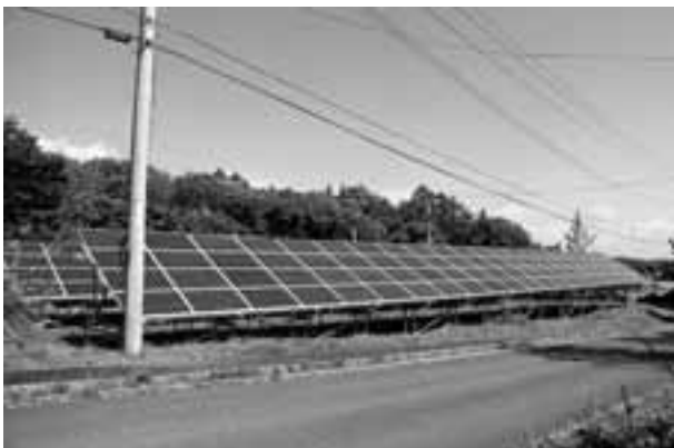
増えている住宅近くのソーラーパネル
