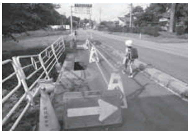
工事が手付かずの通学路
