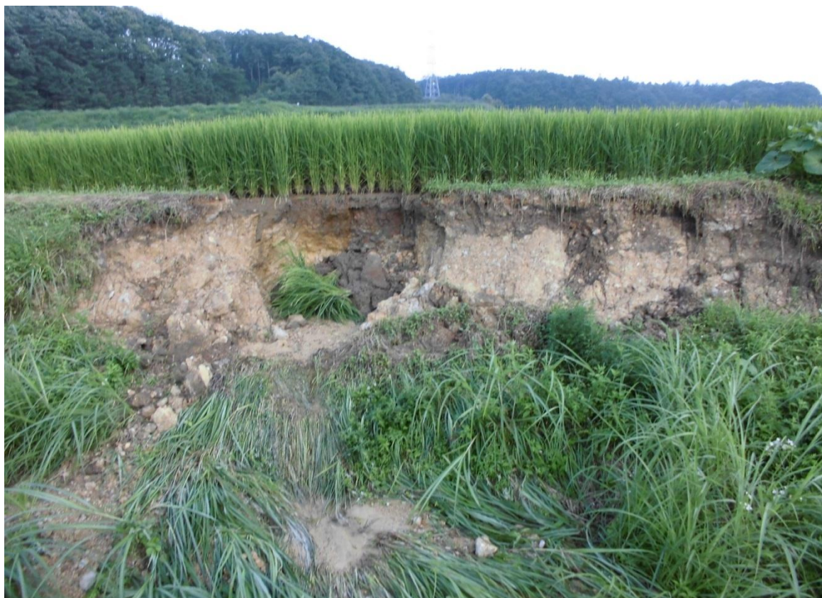
農地被害状況（法面崩壊）
