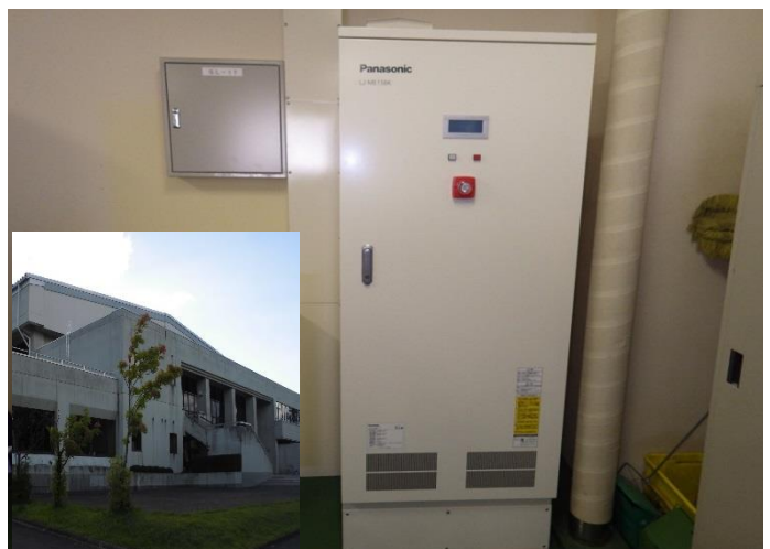
蓄電池 15 kwh (太陽光発電10kw 既設)
