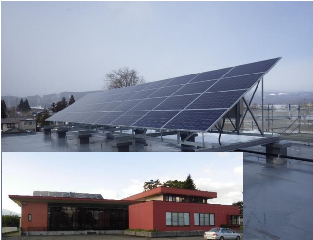
太陽光発電 定格出力 10 kw
