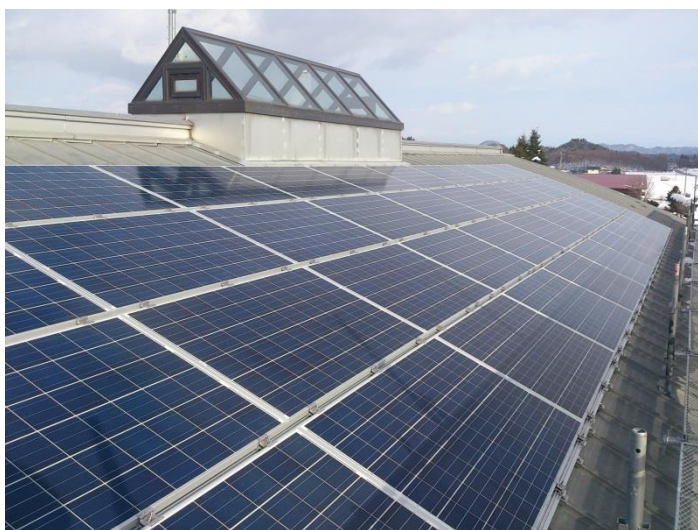
太陽光発電 定格出力 10 kw
