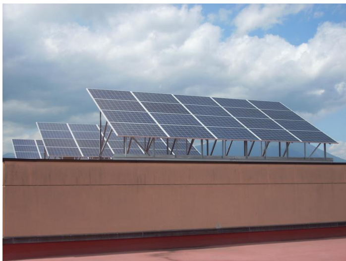
太陽光発電 定格出力 15 kw
